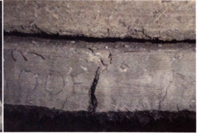
(d) Back Face Crack and Delamination
