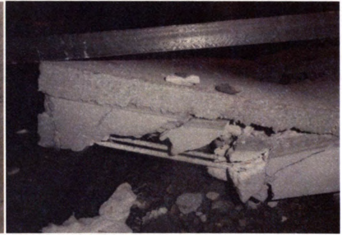
(d) Flexural-Shear Crack in the Back Face
