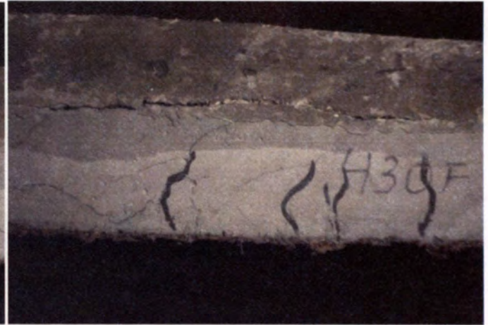
(d) Flexural Cracks in the Front Face
