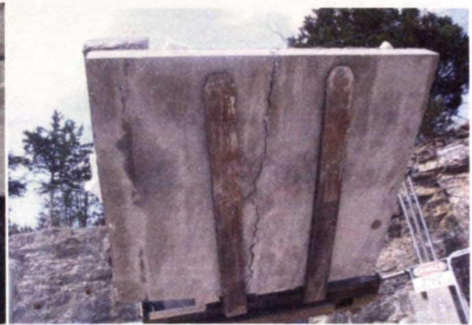
(d) Flexural Crack Tension Face
