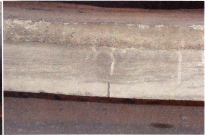
(d) Flexural Crack in the Back Face
